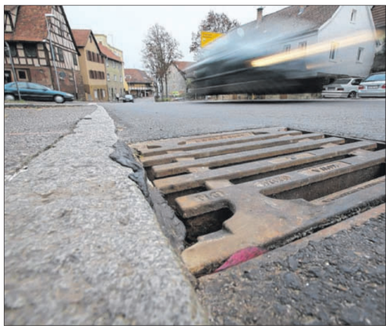
Ein Kanaldeckel in der Oberriexinger Straße in Großsachsenheim: Die Baufirma, die sie eingesetzt hat, muss nachbessern.
